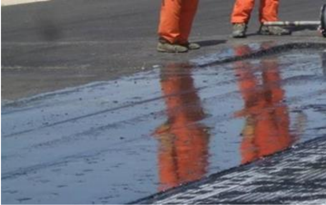
6.1-4 attēls. Spoguļa efekts svaigi izsmidzinātā saistes slānī un melni nospiedumi uz ģeokompozīta pēc pareizas ieklāšanas uz pareizi izsmidzinātas saistvielas
