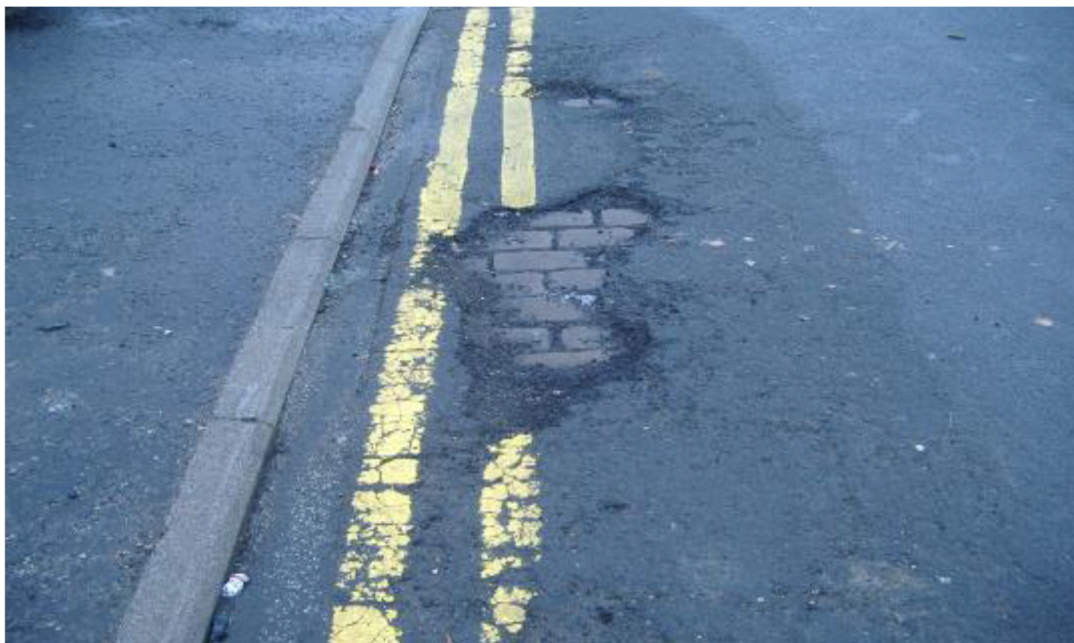
3-1.3. attēls. Dažādi nosēdumi bruģī zem asfalta [56]
