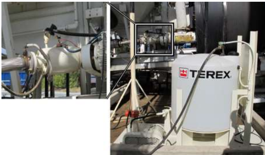
Attēls 4. Putu bitumena ūdens tvertne un ūdens padeves sprauslas bitumena padeves līnijā.
