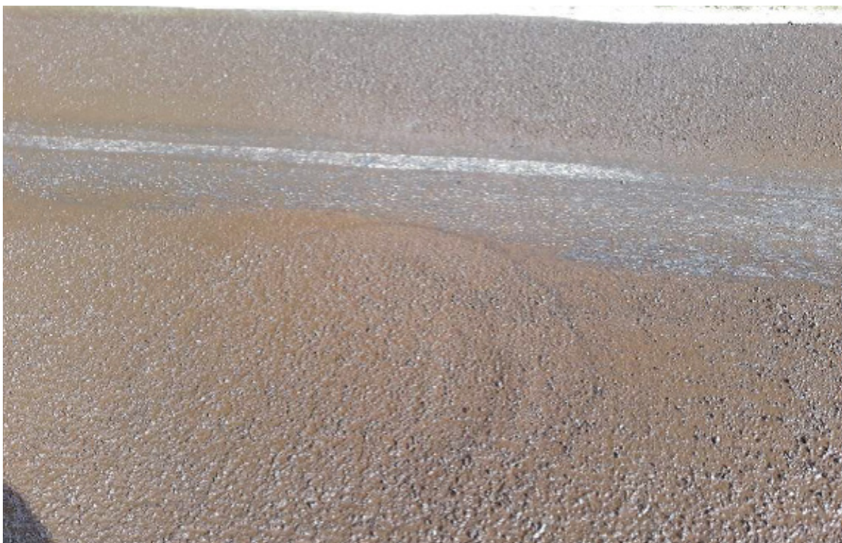
41. att. Aizpildīts lokālais bojājums
