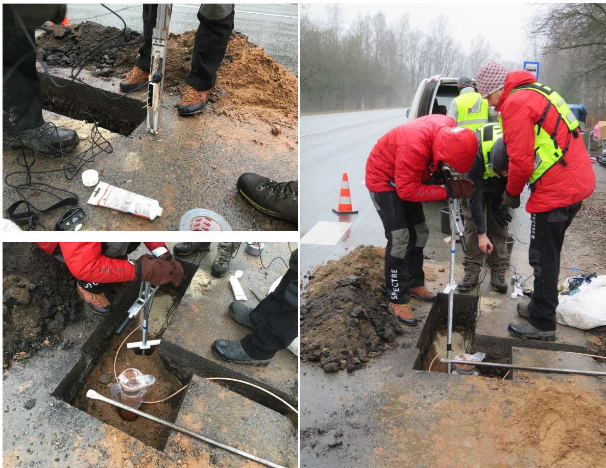
21. attēls. Sensors ielikts sensoru ievietošanas iekārtā (pa kreisi augšējais attēls). Sensora ievietošana precīzā dziļumā (pa kreisi apakšējais attēls). Vadu sakārtošana pirms nākamā sensora uzstādīšanas (pa labi).
