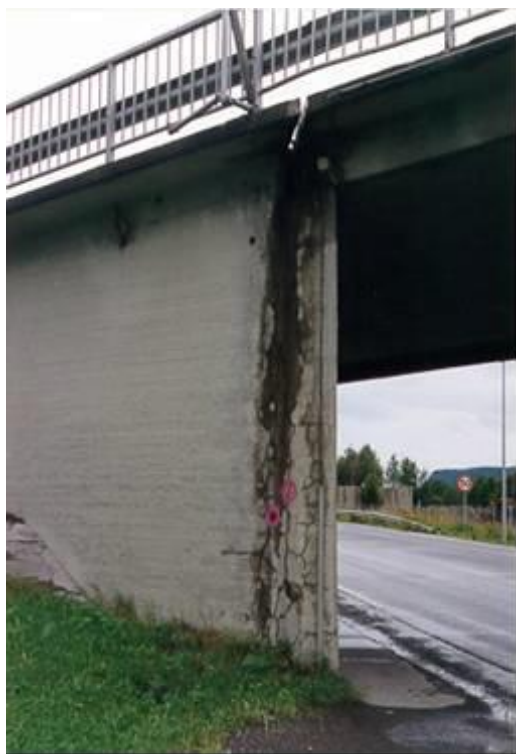
3.3.att. Sārmu-silīcija reakcijas plaisu piemērs ceļa pārvadam Norvēģijā. SSR izraisījis ūdens, kas plūst caur bojātu deformācijas šuvi 18
