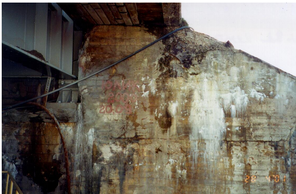
1.3.att. Liela apjoma sārnu-pildvielu reakcijas izraisīti bojājumi (plaisas un sažuvuša gela krāsojums baltā un brūnā krāsā) Ķeguma HES tilta balstošā sienā
