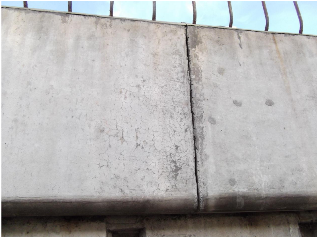
1.7.att. Sārnu-pildvielu rekcijas bojājumi (plaisu tīkls) betonā uz nosedzošo elementu virsmas nesen būvētajam Vairoga ielas satiksmes pārvadam Rīgā.
