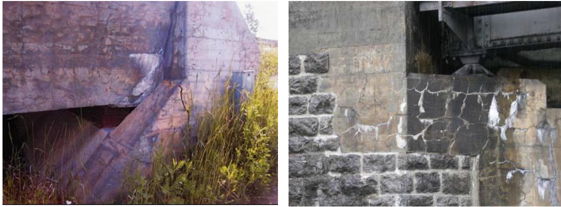
3.5.att. SSR radītu plaisu piemērs autoceļu tiltu balstiem Norvēģijā 20
