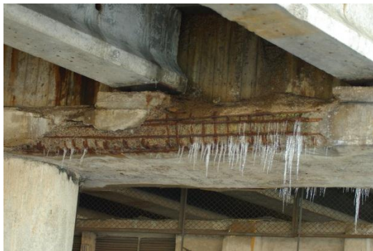
5.1.att. SSR bojājumi tiltā pār Zunda kanālu Rīgā balsta uzkalā
