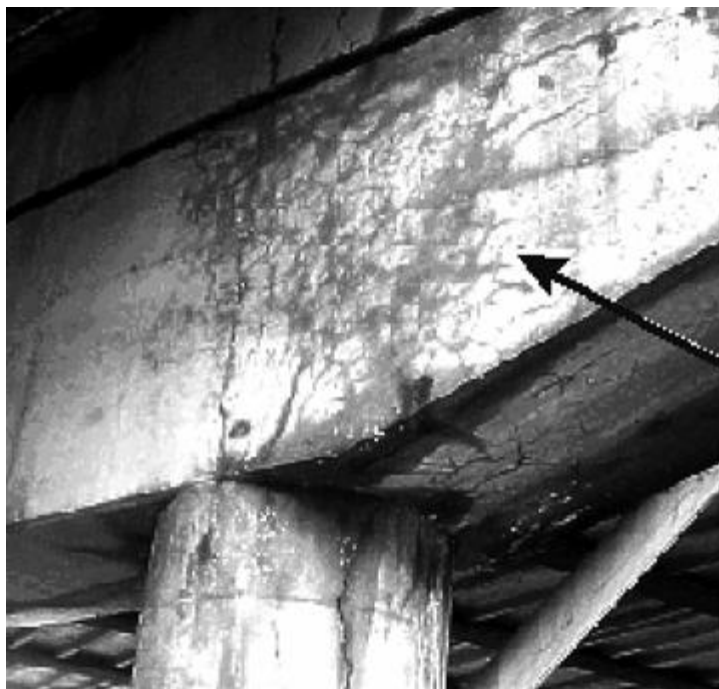
3.15.att. Sulfātu korozijas bojājumi tilta balsta rīgelī 38
