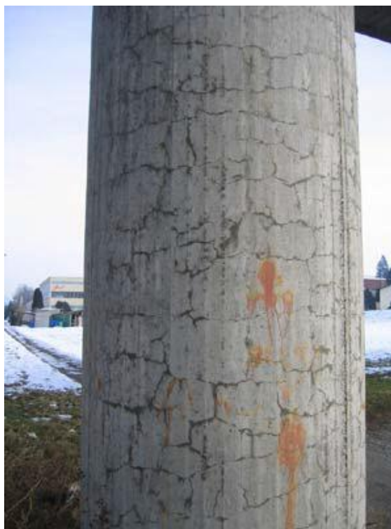
3.4.att. Raksturīgas SSR radītās plaisas tilta balstam Šveicē 19
