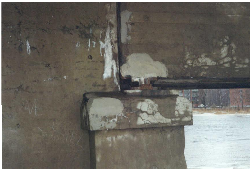
1.2.att. Sārnu-pildvielu reakcijas izraisīti bojājumi (plaisu tīkls) tilta pār Buļļupi Rīgā laiduma un balstu konstrukcijās
