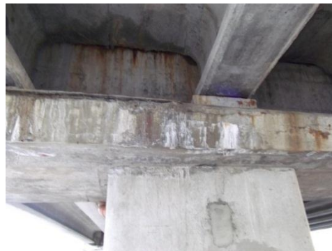
5.2.att. SSR bojājumi Vairogu ielas ceļa pārvada uzkalā.
