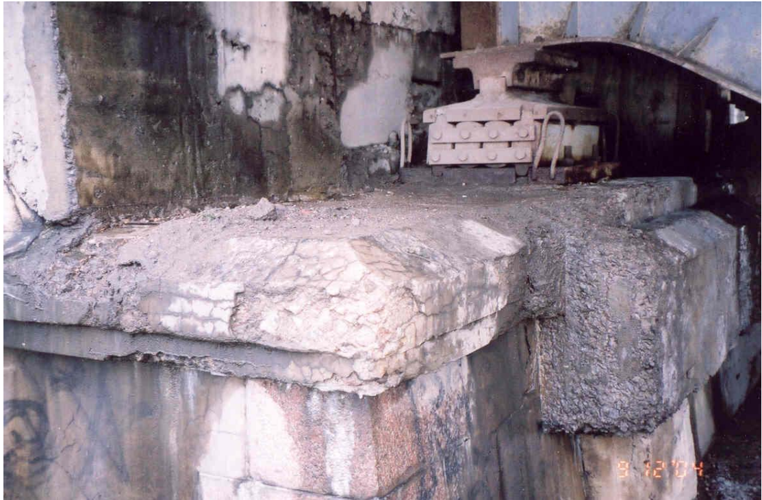
1.4.att. Sārnu-pildvielu reakcijas izraisīti betona bojājumi (plaisas un sadalījies betons) tilta pār Daugavu Daugavpilī kreisā krasta balsta galvā
