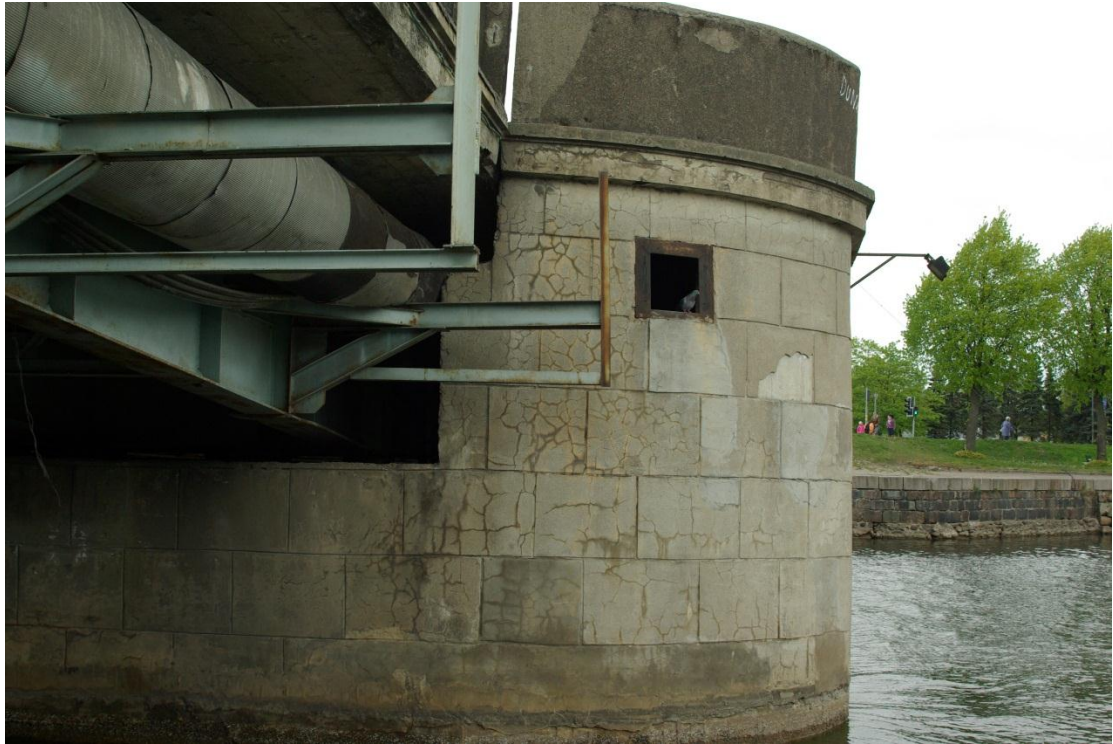
1.6.att. Sārnu-pildvielu rekcijas bojājumi (plaisu tīkls) betona balstā tiltam pār Tirdzniecības kanālu Liepājā
