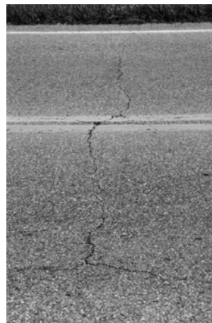
2.8. att. Seguma šķērsplaisa (termoplaisa) [9]
