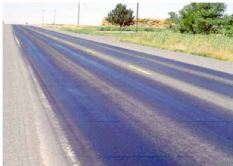
2.16. att. Seguma svišana (bleeding) [14]
