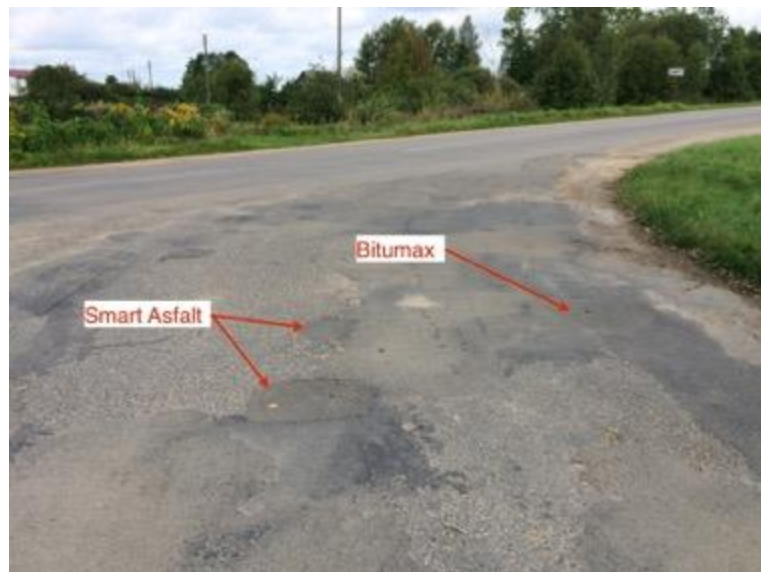
6-13 . attēls. Liepu ielas turpinājums aiz apbraucamā ceļa Preiļos. Remontētās bedrītes
