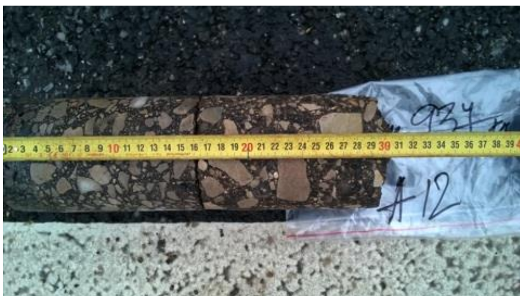
8-10 attēls. Izurbtais asfalta un reciklētās kārtas paraugs 93,7 km
