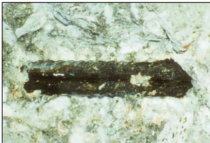
7.3.-15. att. C pakāpes korozijas piemērs
