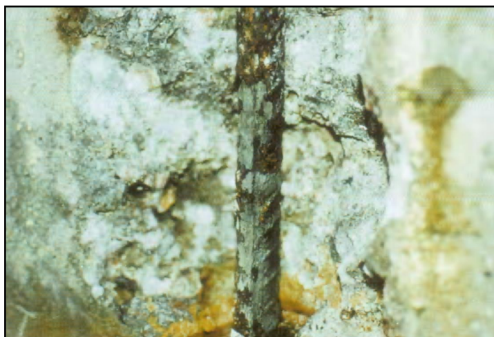
7.3.-16. att. D pakāpes korozijas piemērs
