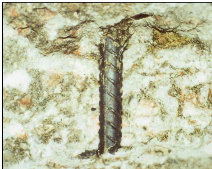
7.3.-13. att. A pakāpes korozijas piemērs
