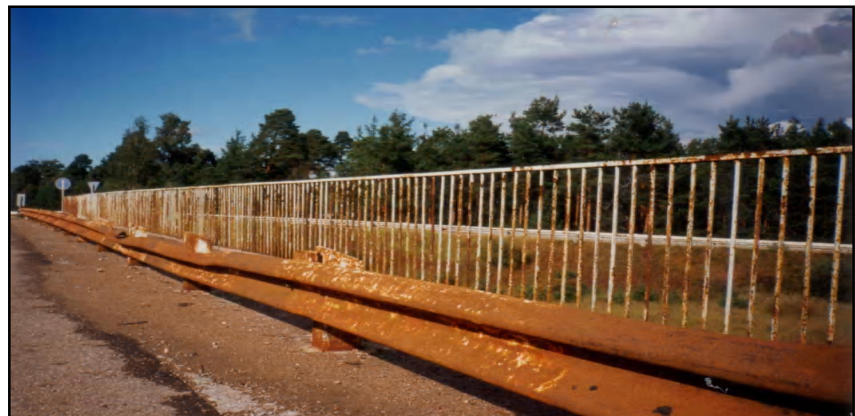
6.4.-8. att. Bojāts krāsojums/korozija
