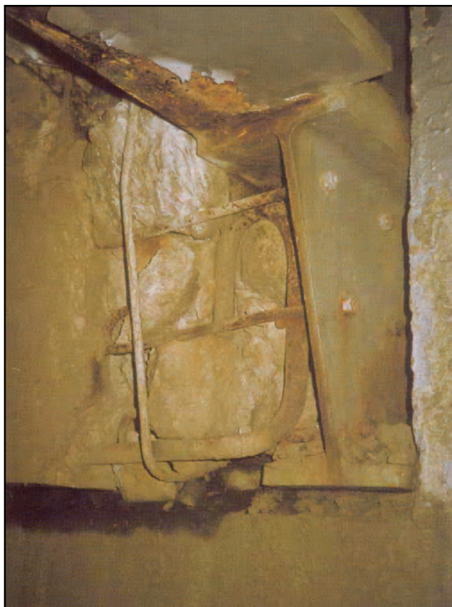
6.3.-2. att. Lūzums betona šķērssiņā
