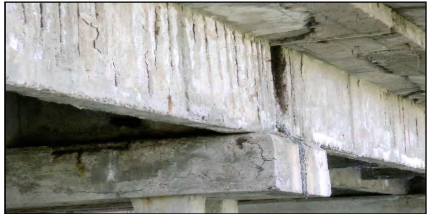
6.4.-2. att. Stiegrojuma korozija un betona atslāņošanās
