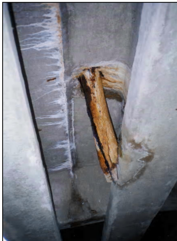
6.4.- 9. att. Drenāžas caurules bojājums/korozija
