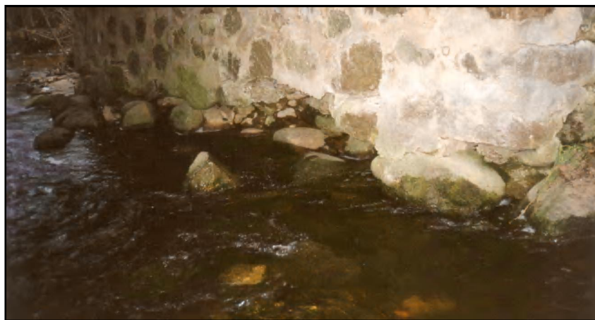
6.3.-4. att. No mūra izkrituši akmeņi
