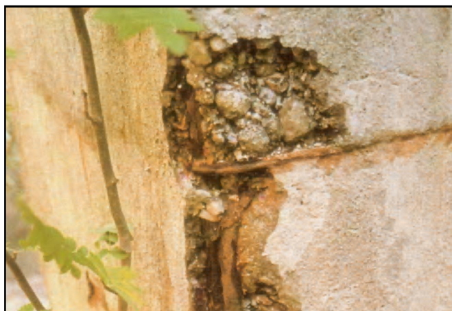
5.6.-2. att. Stiegrojuma korozijas cēlonis - 32 Nepareizi izvietots stiegrojums, 34 Neatbilstošs nobeigums.
