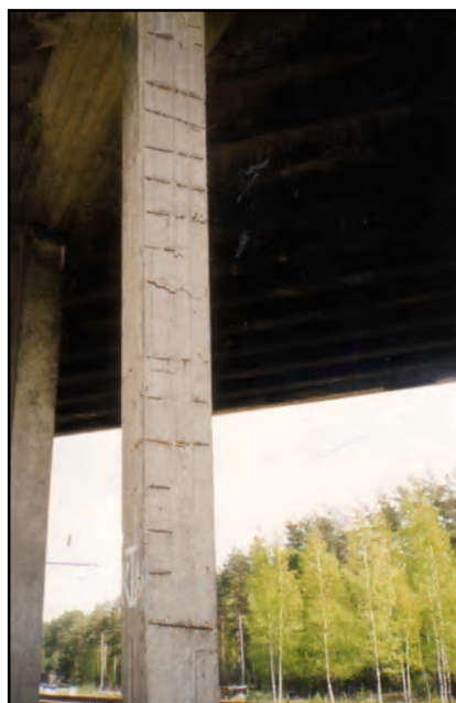
5.4.-2. att. Neatbilstoša/bojāta aizsargkārtā. Stiebrojuma korozija un atslāņošanās.
